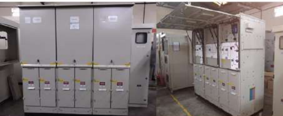
HV RMU Panels
